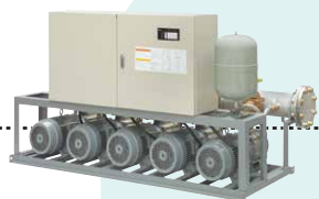
陸上給水ポンプ 推定末端圧力一定給水
