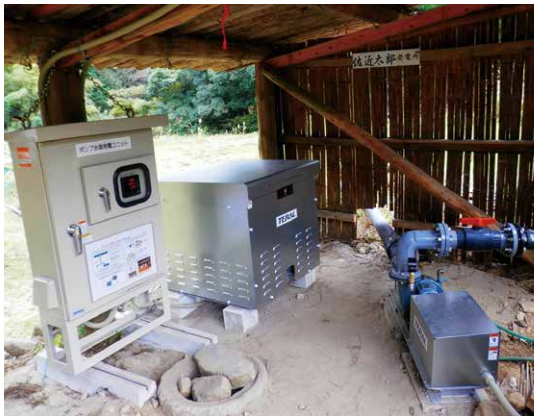
ポンプを利用した発電設備
