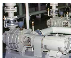
■ 既設の給水ポンプ (5.5kW×2台)
